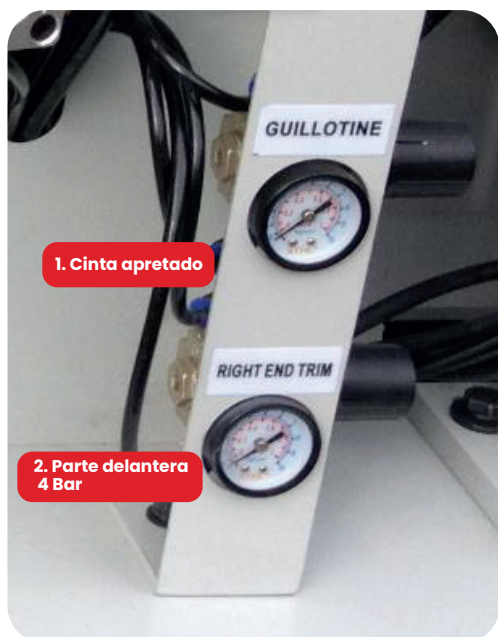
Imagen 4-1 Manómetro de presión de aire
