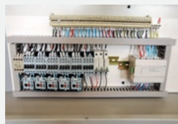
Componentes eléctricos Siemens y control PLC
