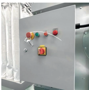
8. Gabinete de control eléctrico
