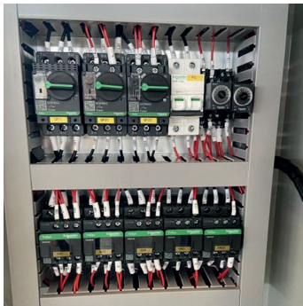
9. Disposición de componentes eléctricos
